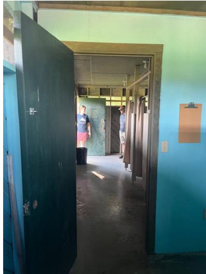
DOORWAYS – NOT ADA ACCESSIBLE
